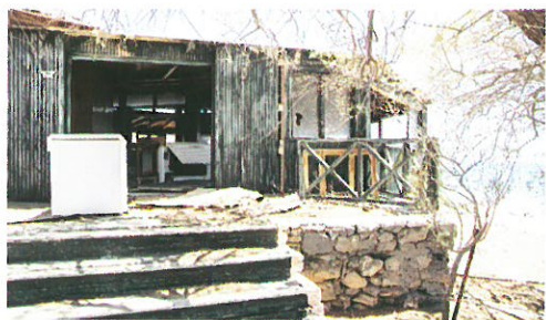
Μεταβολή αιγιαλού και αυθαίρετη δόμηση σε προστατευόμενη περιοχή του δικτύου Natura 2000. Νήσος Ντία. (Φωτ. ΜΦΙΚ).
